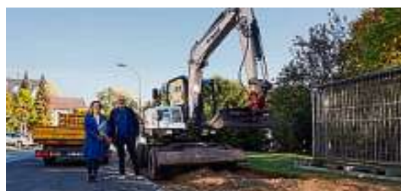
Endlich geht's los: Derya Öcal und Kurt Liebermeister auf der Baustelle in der Berliner Straße. Foto: Privat
